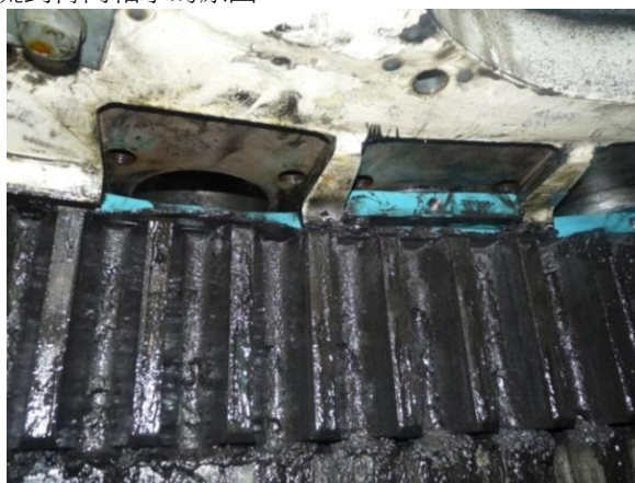
圖 4、漏油情形照片
