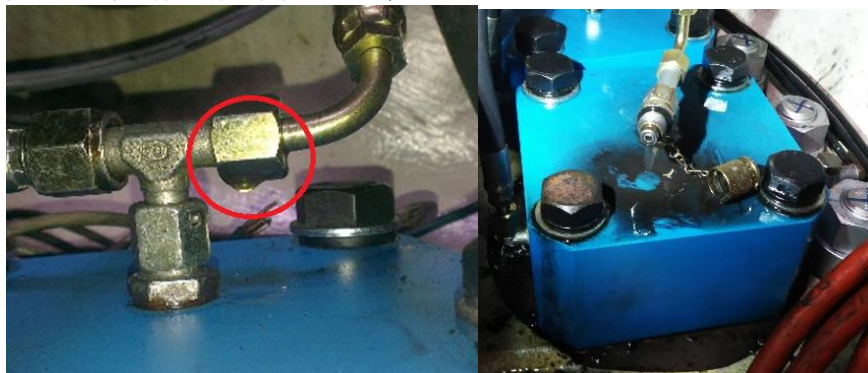
圖 15、管路接頭及排放空氣閥洩漏
