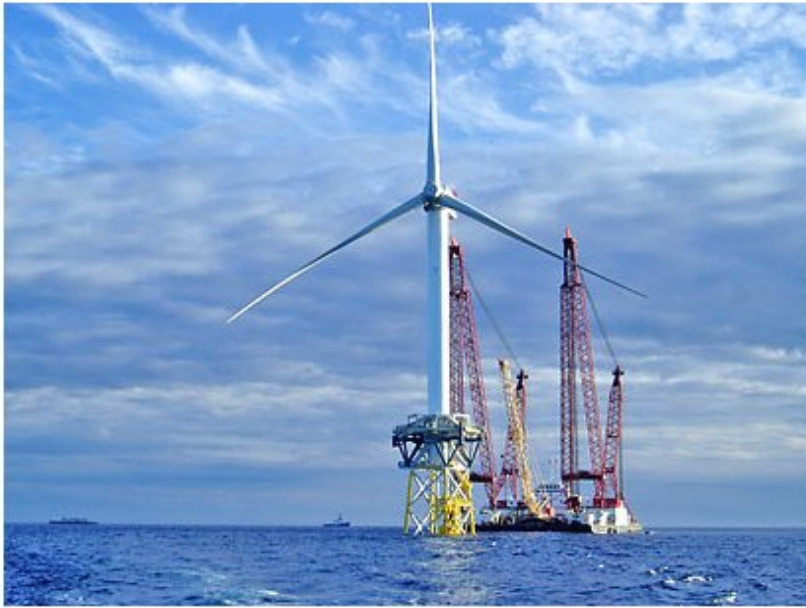
圖 1 5MW REpower 離岸風力機
